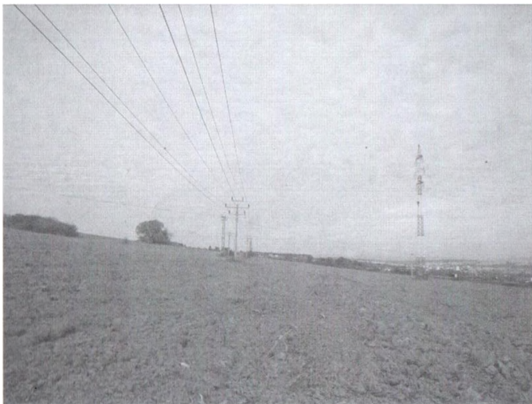
Kríženie so 110kV, 22kV VSE a Podperný bod č 56
