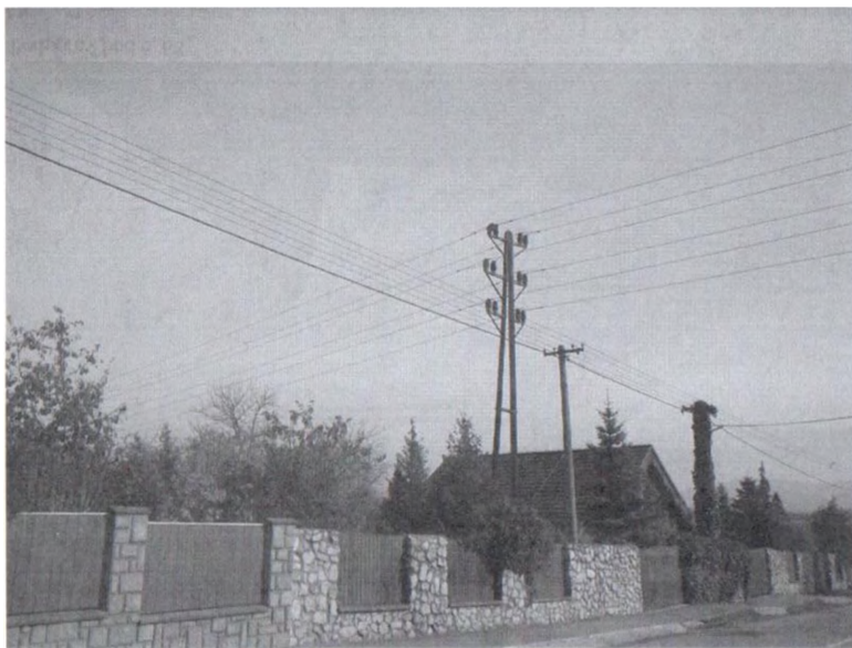
Križenie s NN VSE (VO) Rozhlas na Bystrickej ulici Podperný bod č. 66
