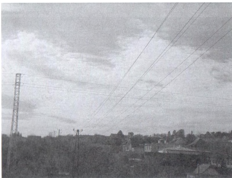
Križovanie s VN vedením 22kV medzi podpornými bodmi č 69 a 70
