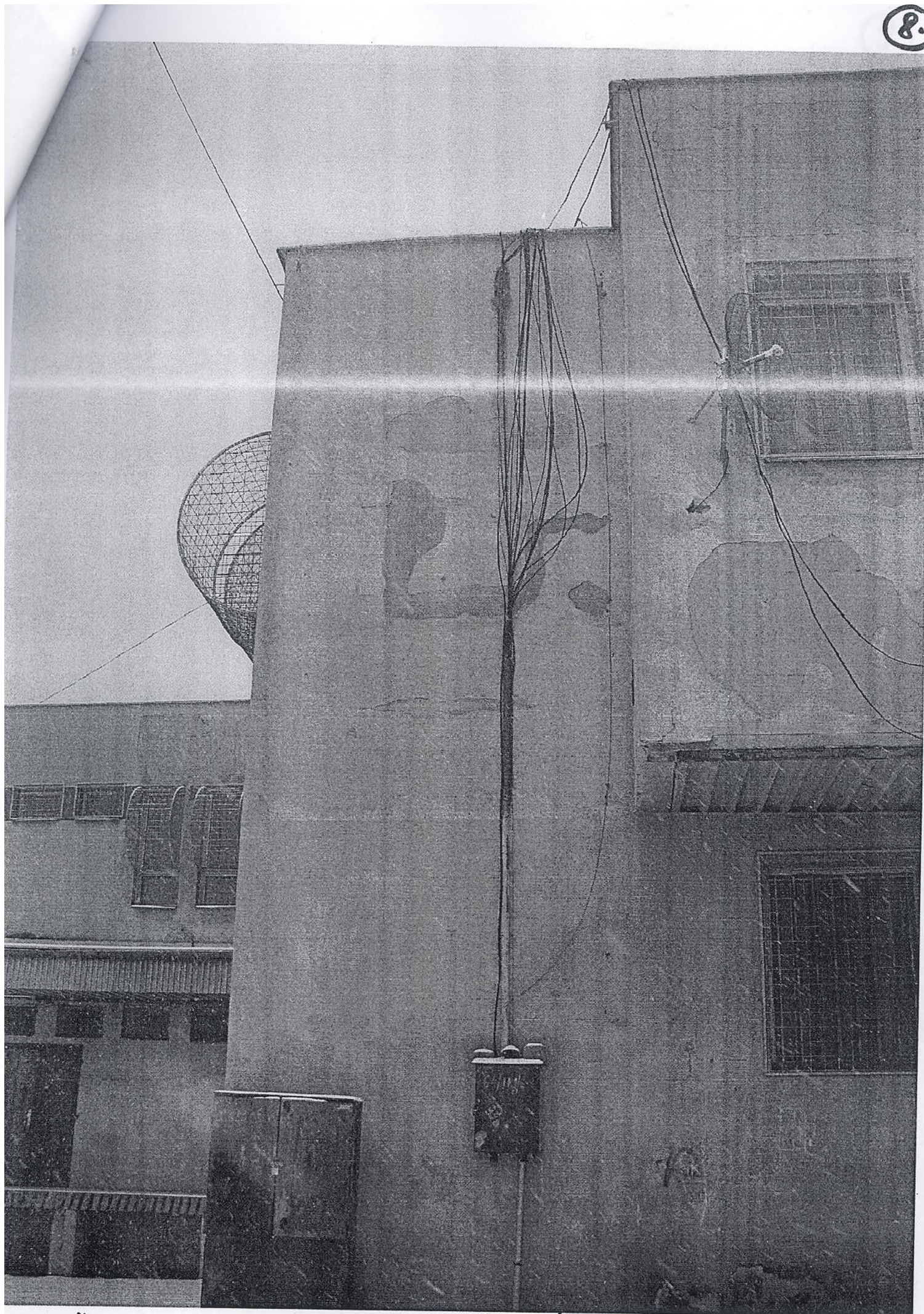
POHLÁD NA NEVHODNĚ ULOŽENÉ ROZVODY ELEKTRO
